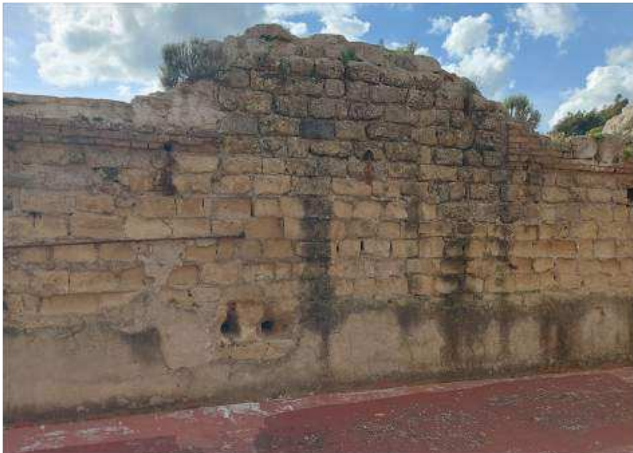
Figura 1- Presenza di umidità nelle strutture murarie al III livello, corpo 07
