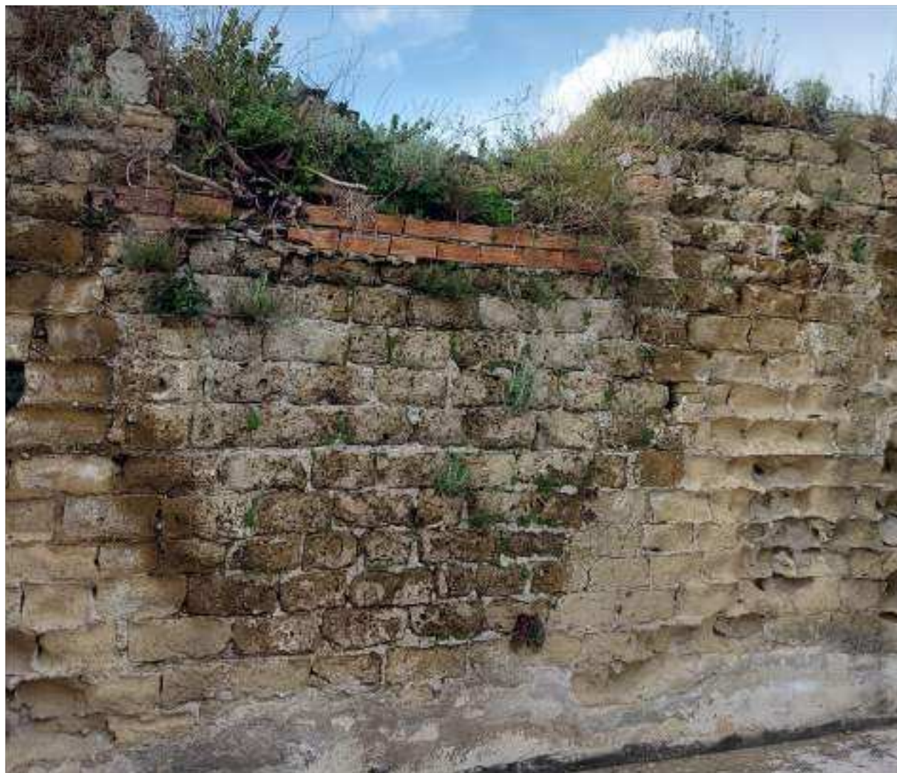
Figura 6 - In alcune porzioni del blocco 07 è possibile riscontrare un fenomeno di erosione differenziata a seconda dei blocchi lapidei usati e della malta impiegata.
