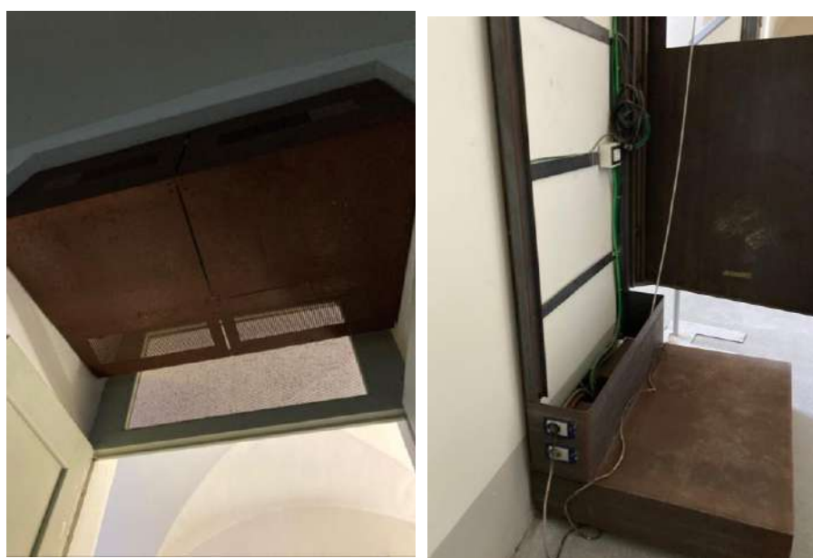
Figura 12 Viste terminali ambiente (fan coil) e totem per la distribuzione degli impianti elettrici
